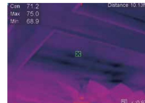
Intrusión de Humedad
